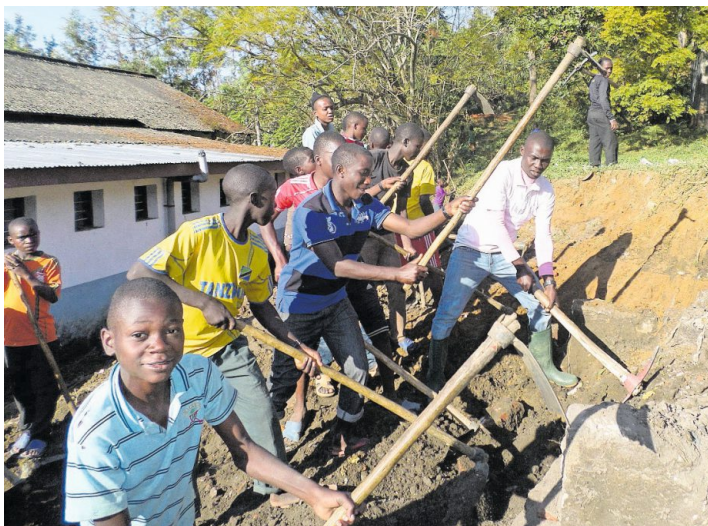
Einheimische Jugendliche und Erwachsene helfen tatkräftig bei der Realisierung eines früheren Bauprojekts in Tansania. Bild: Markus Willi
